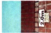
SEÑALIZACIÓN: Deberá marcarse la profundidad mínima, máxima e intermedia de la piscina.
